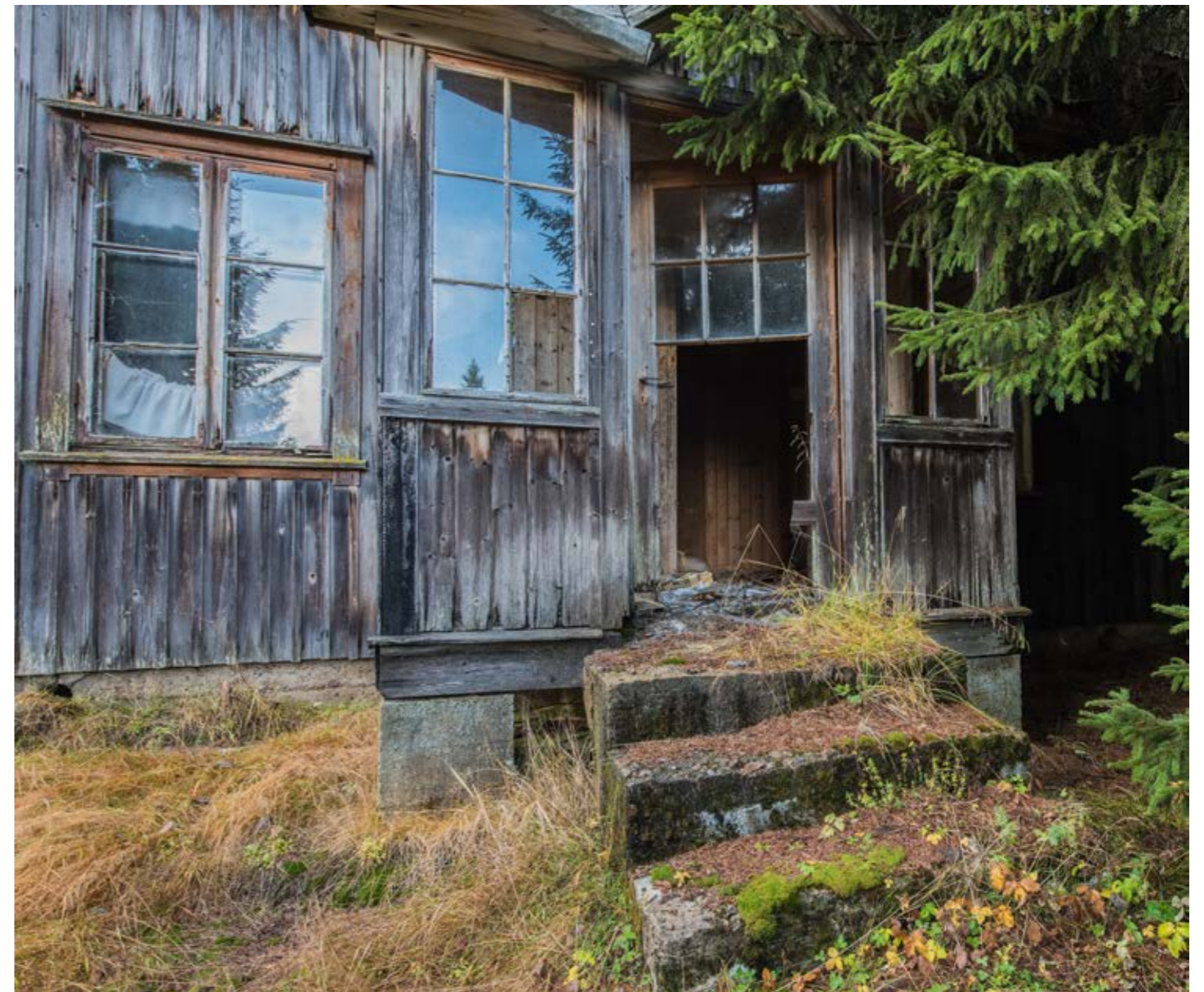
Naturen tar seg inn i et forlatt hus. Huset er standhaftig, men naturen har ingen hast. En vindusrute blir knust, en planke gir etter og en dør åpner seg. Så er mulighetene der: Vann siger inn, mose og lav kryper innover og maur og andre insekter finner et nytt hjem. foto: Kjell Germeten
